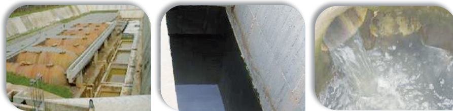
» Sistema de tratamiento
